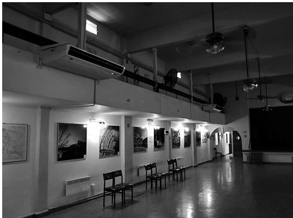
Vista del salón con los aires acondicionados obtenidos mediante un subsidio del Gobierno de España.
